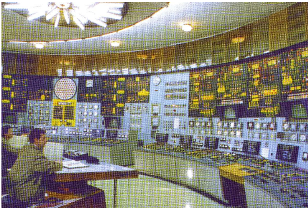
Блочный щит управления Нововоронежской АЭС
